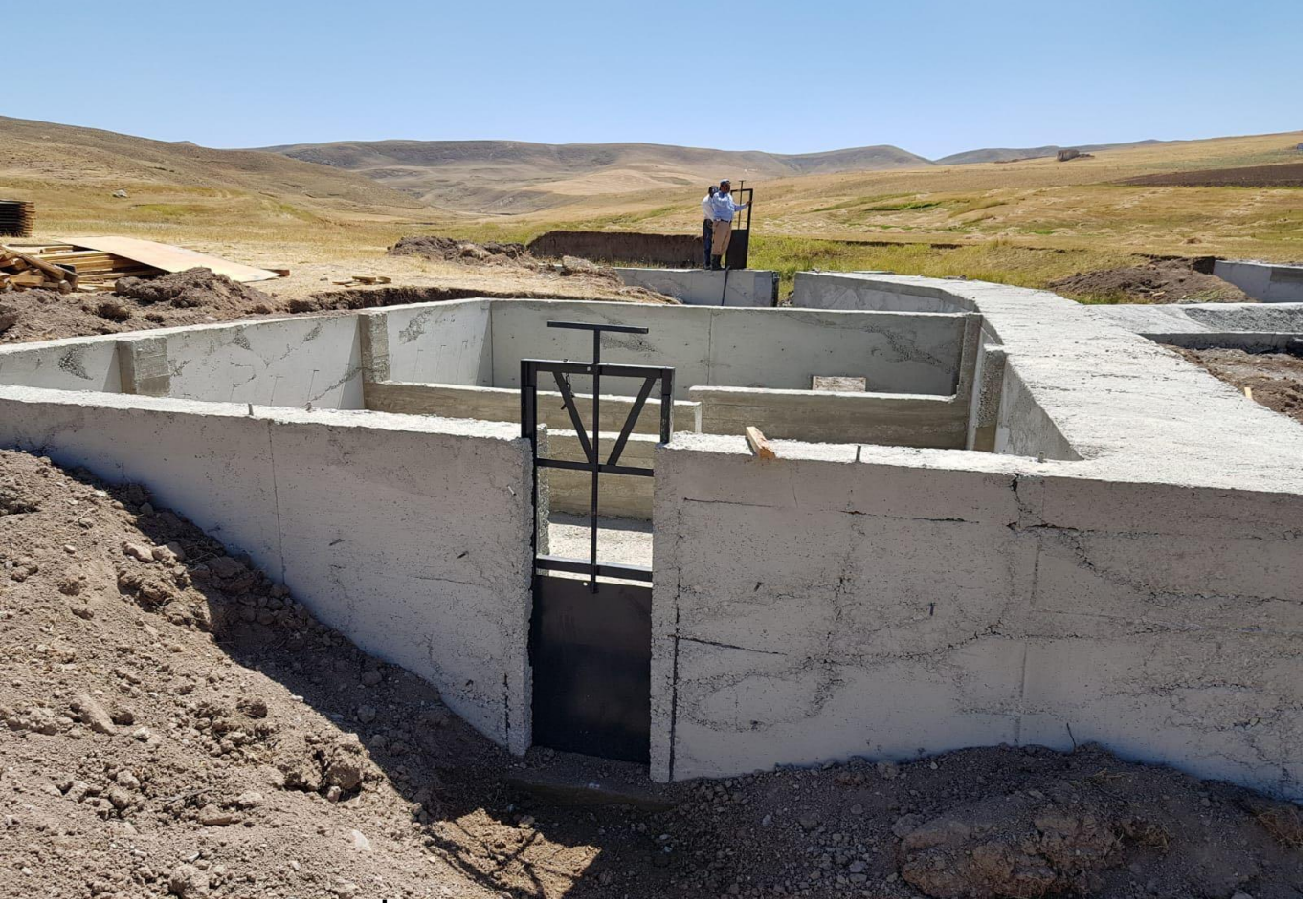
Malazgirt İlçesi Adaksu Köyü Kapalı Sistem Sulama Tesisi
