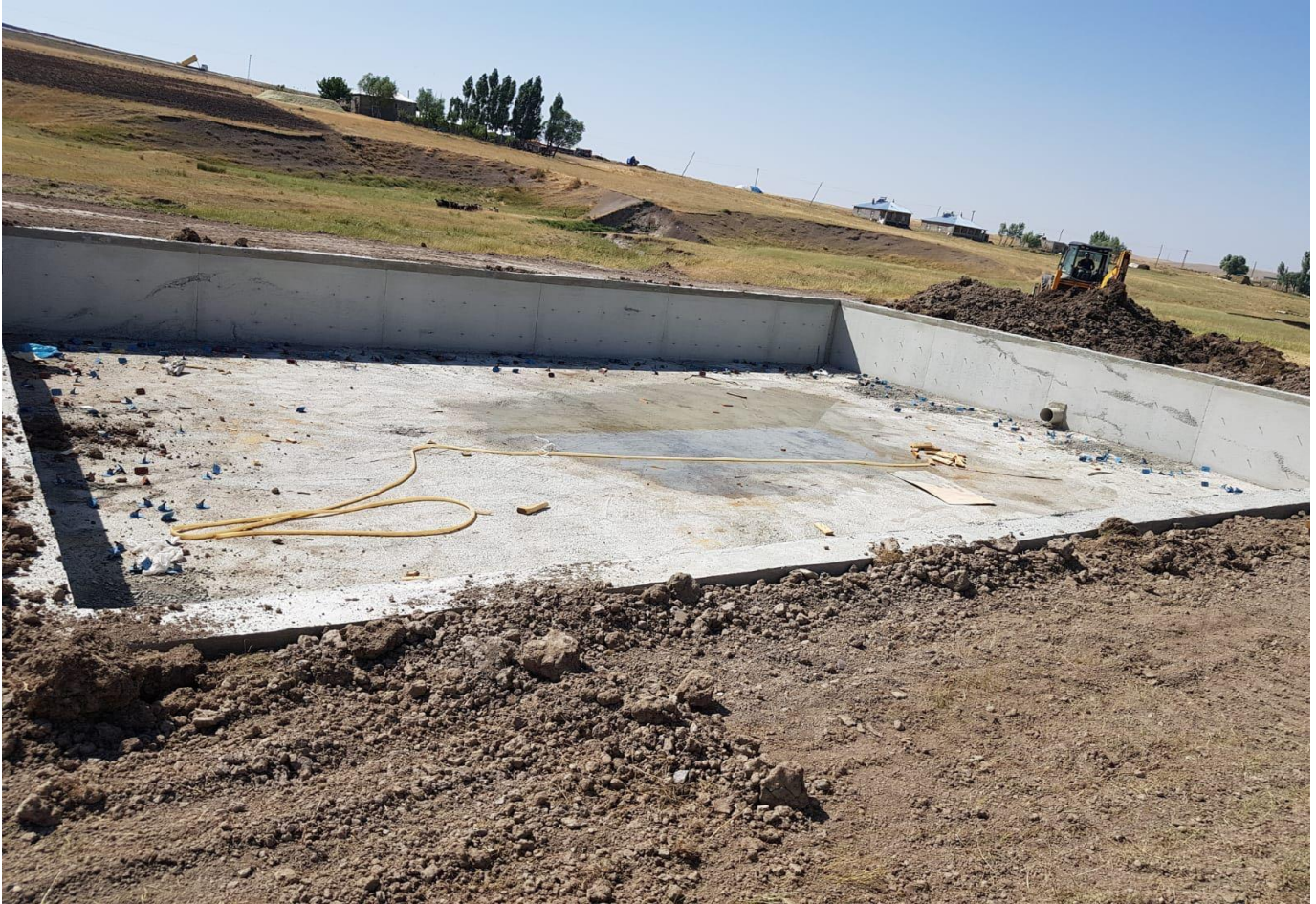
Merkez Ekindüzü, Ağıllı Köyleri Kapalı Sistem Sulama Tesisi
