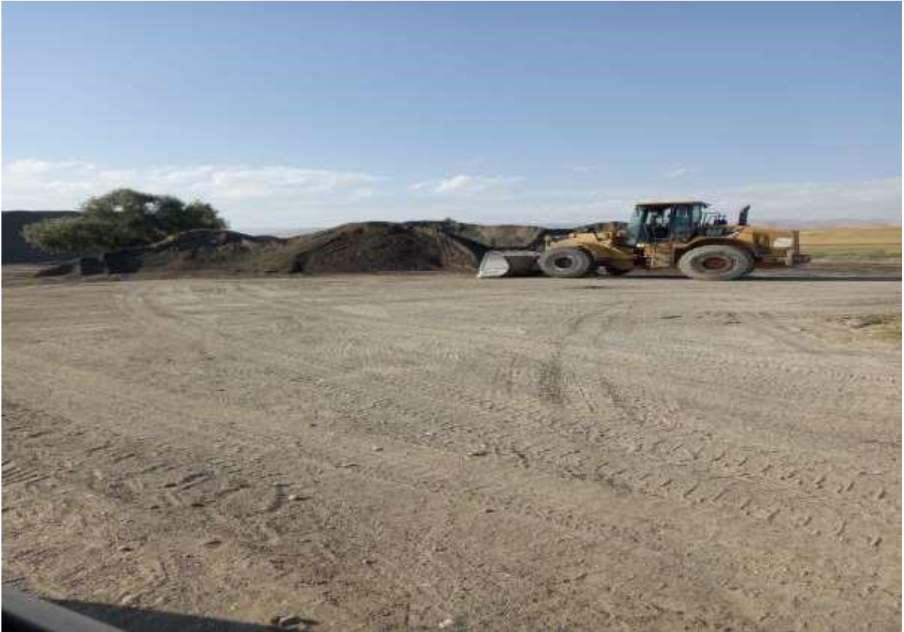
Muş İli Merkez İlçesi Kıyık Köyü Sınırlarında Bulunan Ahmet YALVARICI' ya Ait Kum Kırma, Yıkama ve Eleme Tesisinin 03.10.2022 Tarihindeki Denetim Görüntüleri.
