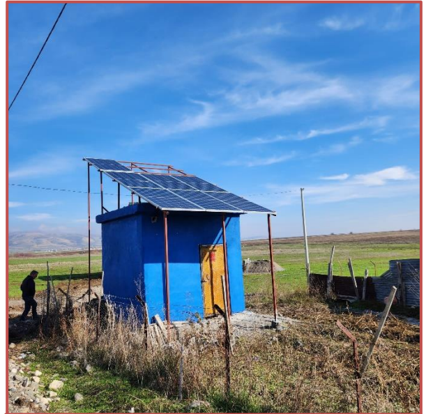
Ziyaret Köyü Güneş Enerjili İçme Suyu
