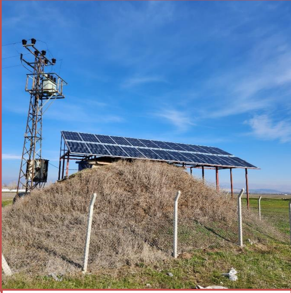
Kıyık Köyü Güneş Enerjili İçme Suyu
