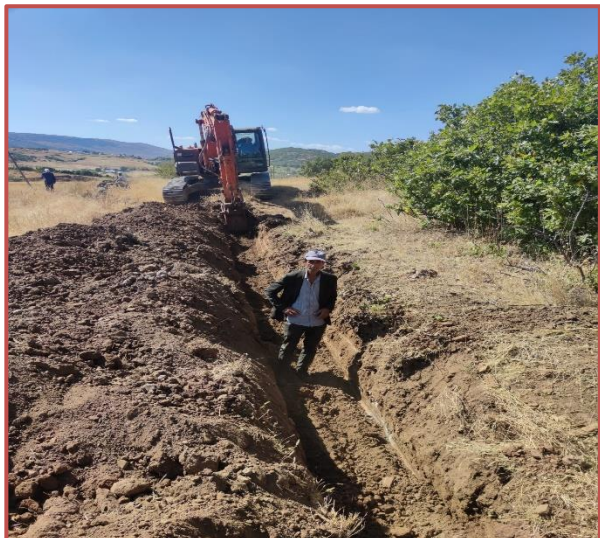
Teknedüzü Köyü İçme Suyu/VARTO
