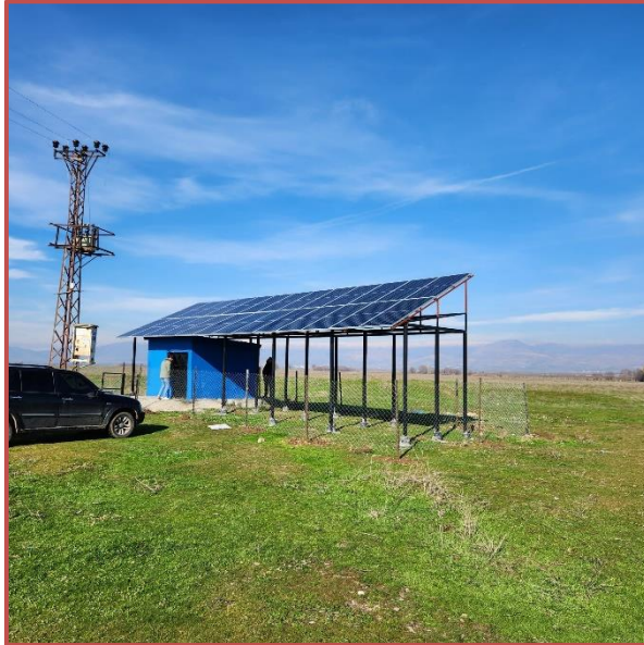
Ortakent Köyü Güneş Enerjili İçme Suyu
