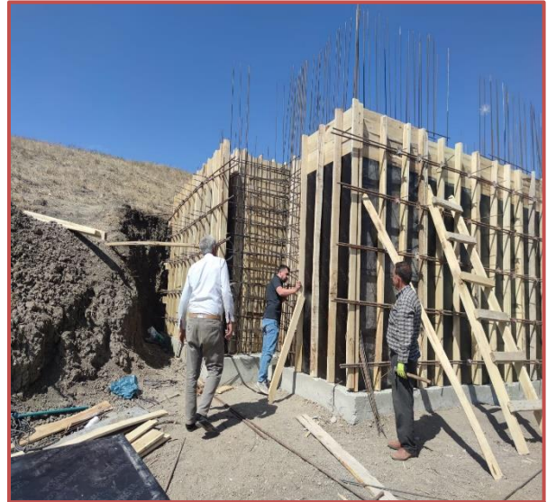
Şatırlar Köyü İçme Suyu Deposu/BULANIK
