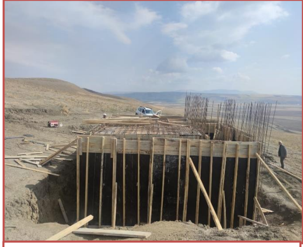
Şehittahir Köyü İçme Suyu Deposu/BULANIK
