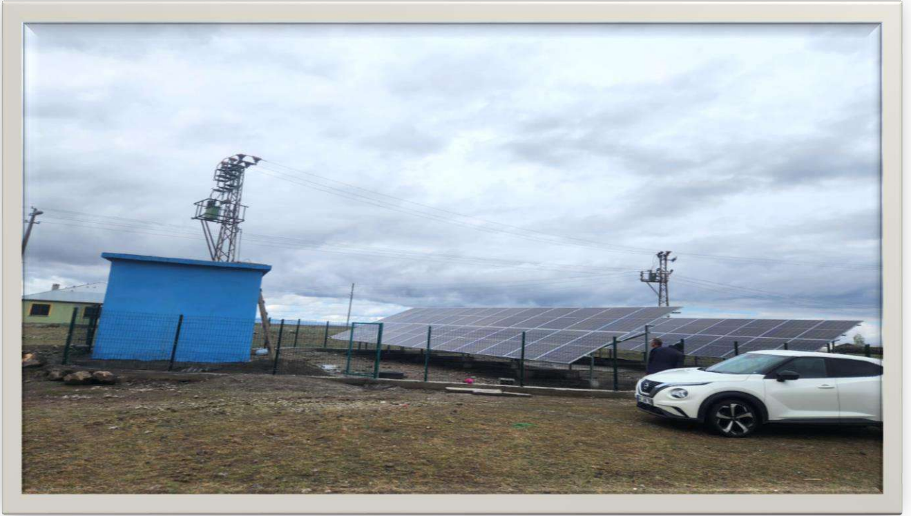
Malazgirt Kurtulmuşoğlu Köyü Güneş Enerjili İçme Suyu Tesisi
